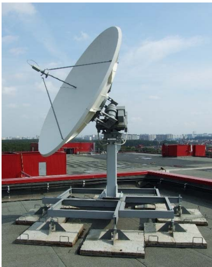
Рис.2.1. ОПУ и антенна станции УниСкан на крыше здания.
